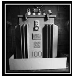
高圧トランス
