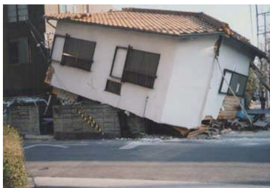
1階部分が層崩壊した木造2階建ての建築物
