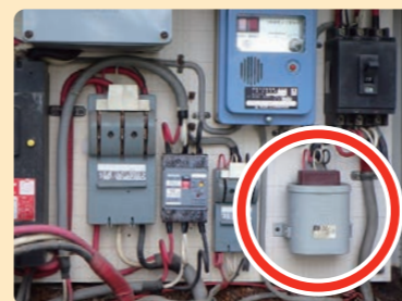
低圧分電盤内の低圧コンデンサー
