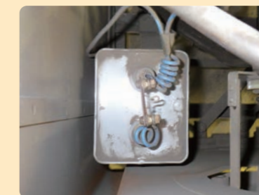
電気溶接機の内部に取り付けられた低圧コンデンサー
