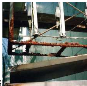
袖看板の底部脱落
